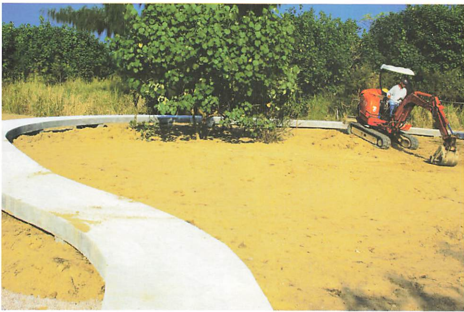
▲看這步道施工，材質與工法是非常不友善環境的。
